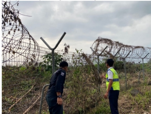
Gambar 4 Personel Aviation Security melakukan pengecekan pada kawat duri yang terlepas dari pagar perimeter
